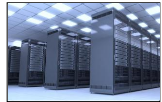
データセンター・サーバールームに
