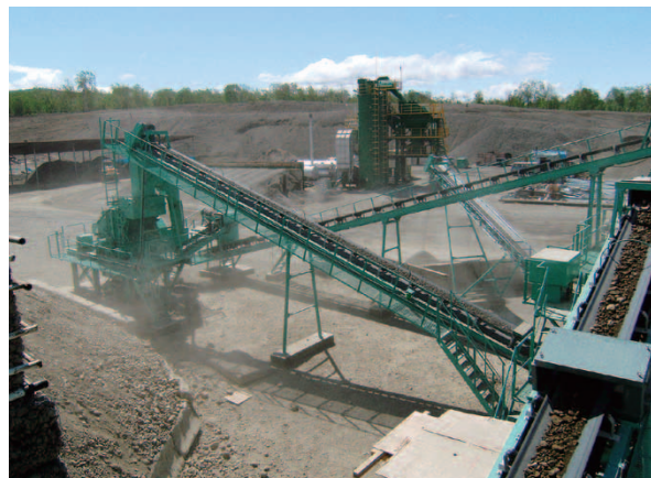
砕石プラント(手前)・アスファルトプラント(奥)
